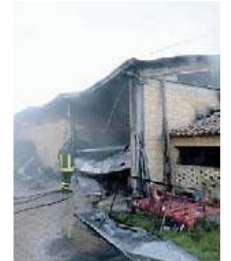
Il capannone a fuoco
